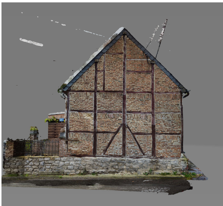
Figure 15 Vue par photogrammétrie du mur pignon d'une maison à Havelange (J. Denet)
